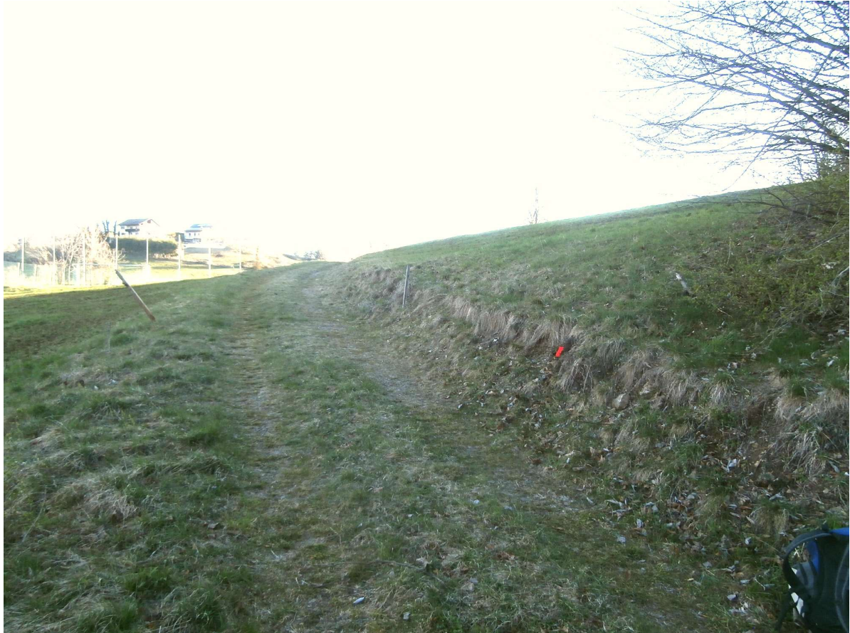
„Aufschlussituation“ entlang des Wiesenweges beim Sportplatz am Pfarrerkogel südlich von St. Pankrazen. 5.4.2026.
